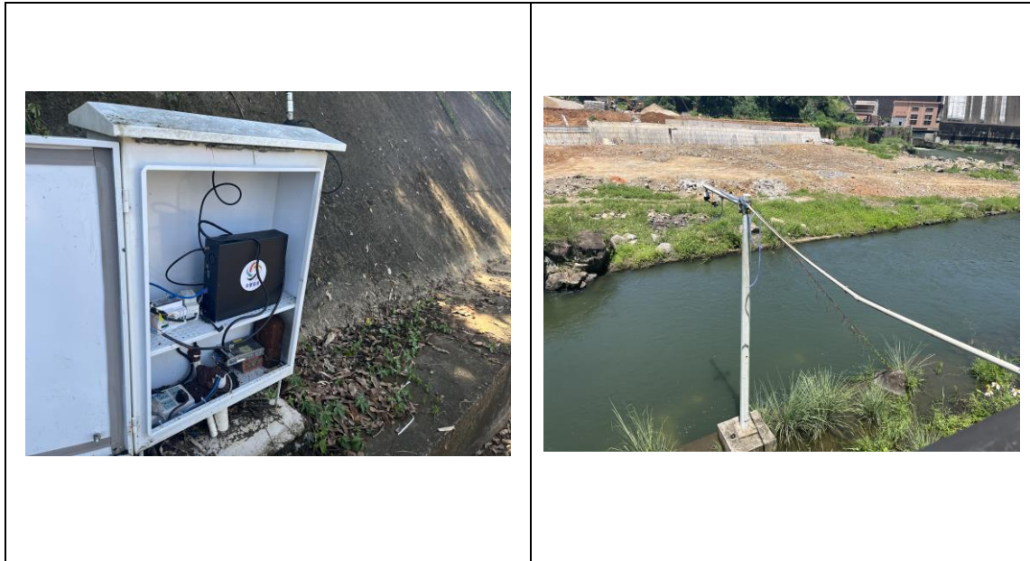
图2-6 最小下泄流量安装现状图
